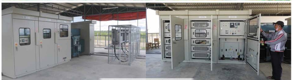
Solar Power - 0.5 MW
