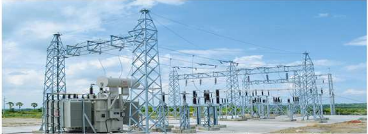
မြို့သာစက်မှုဥယျာဉ်တွင် အမှတ် (၁) 20 MVA Substation တည်ဆောက်ပြီး
